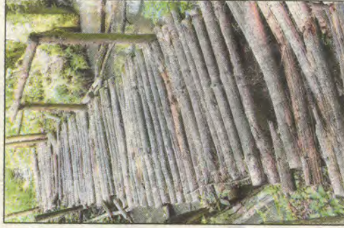
Marode Bohlenbrücke: Viel bleibt im Wegenetz noch zu tun.
